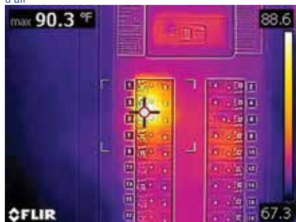
La zone délimitée d'un point chaud montre qu'un fusible électrique est actif
