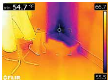
La zone délimitée d'un point froid montre les infiltrations d'air
