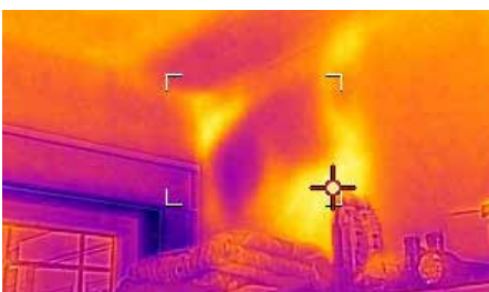
Temperaturmuster zeigen Gebäudemängel wie fehlende Dämmungen an.
